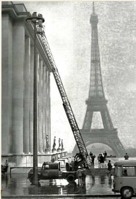
1961 : Remplacement de lampes place du Trocadéro
